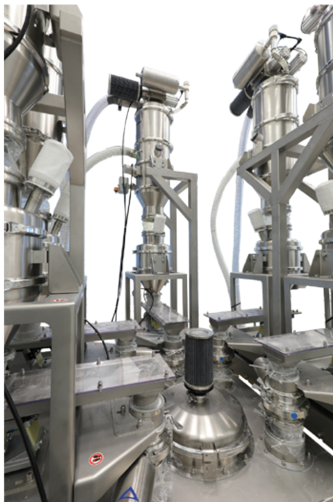
Anlage bei einem Lebensmittelproduzenten: Fördern und Dosieren von 5 Komponenten eines Rezepts in einen Mischer
